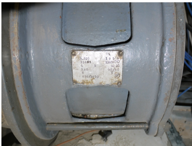
Detalhe da máquina de tração.
