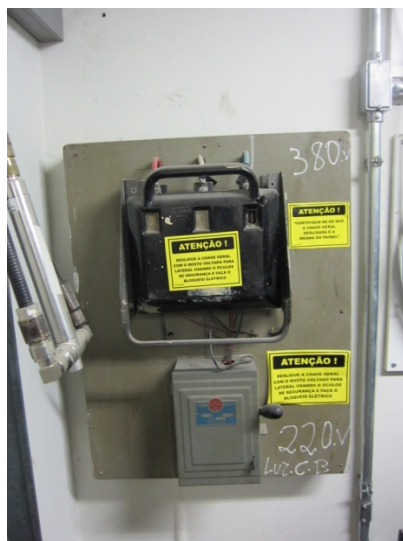
Painel de força.
