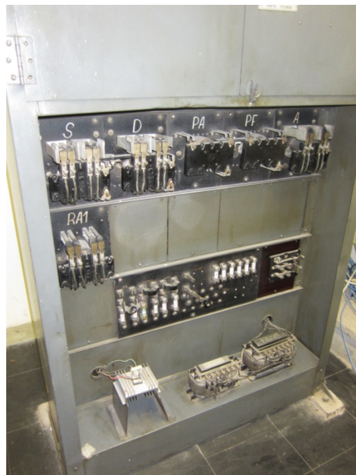
Quadro de comando
