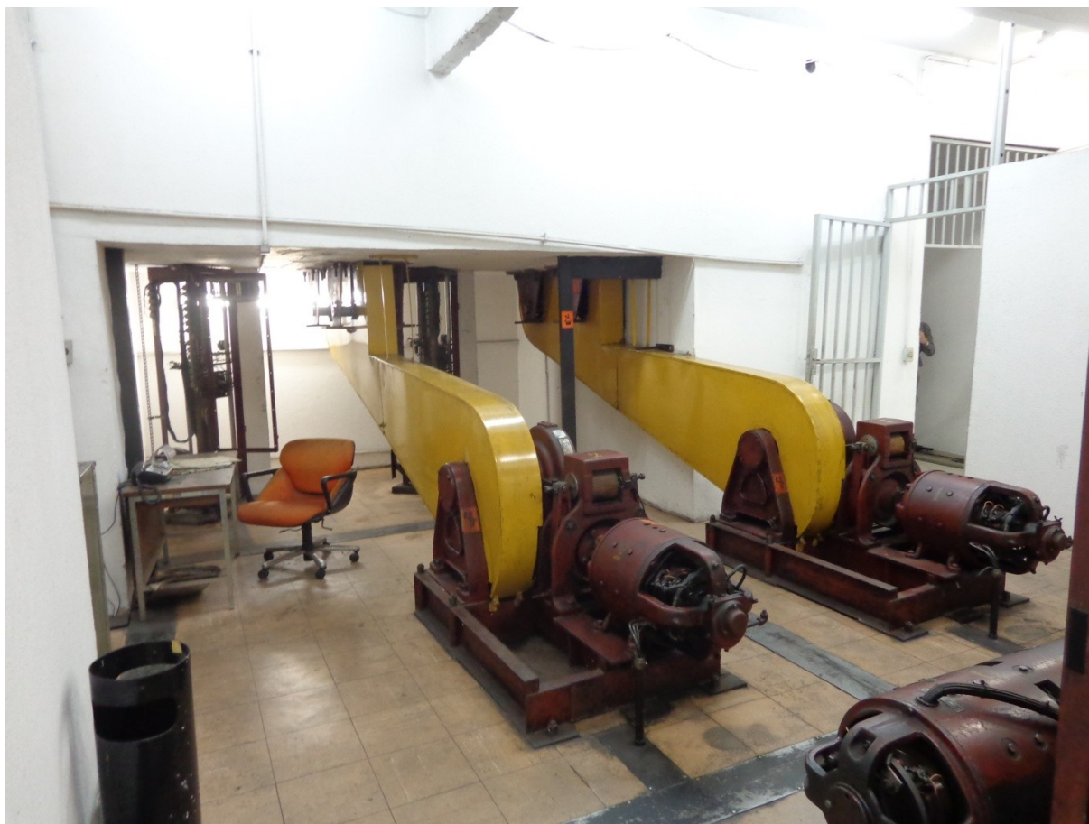
FOTO 43 – Casa de máquinas dos elevadores do Bloco B do edifício Anexo II. Os elementos deverão ser substituídos conforme especificações do Anexo 04 do edital. A CONTRATADA deverá realizar adequações a essa casa de máquinas, inclusive substituição do piso.
