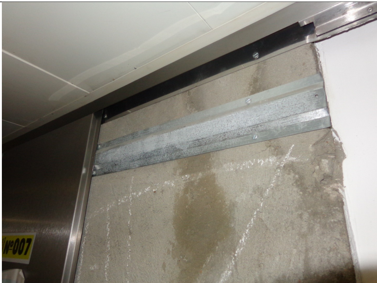
FOTO 20 – Modo de fixação das placas de aço inoxidável no edifício Anexo I. As placas de aço inoxidável na fachada para instalação de botoeiras nas novas posições deverão ser substituídas conforme especificações do Anexo 04 do edital.
