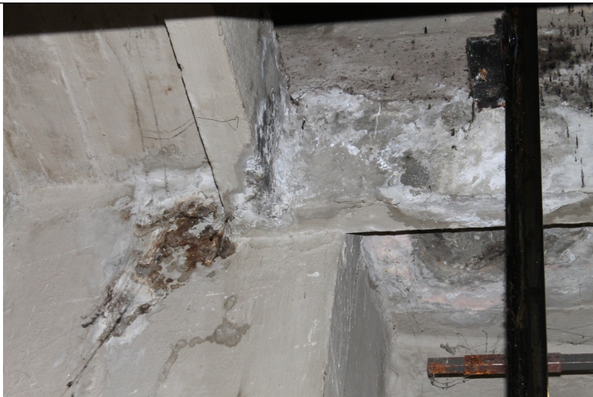
FOTO 6 – Parede no poço dos elevadores do edifício Anexo I.
