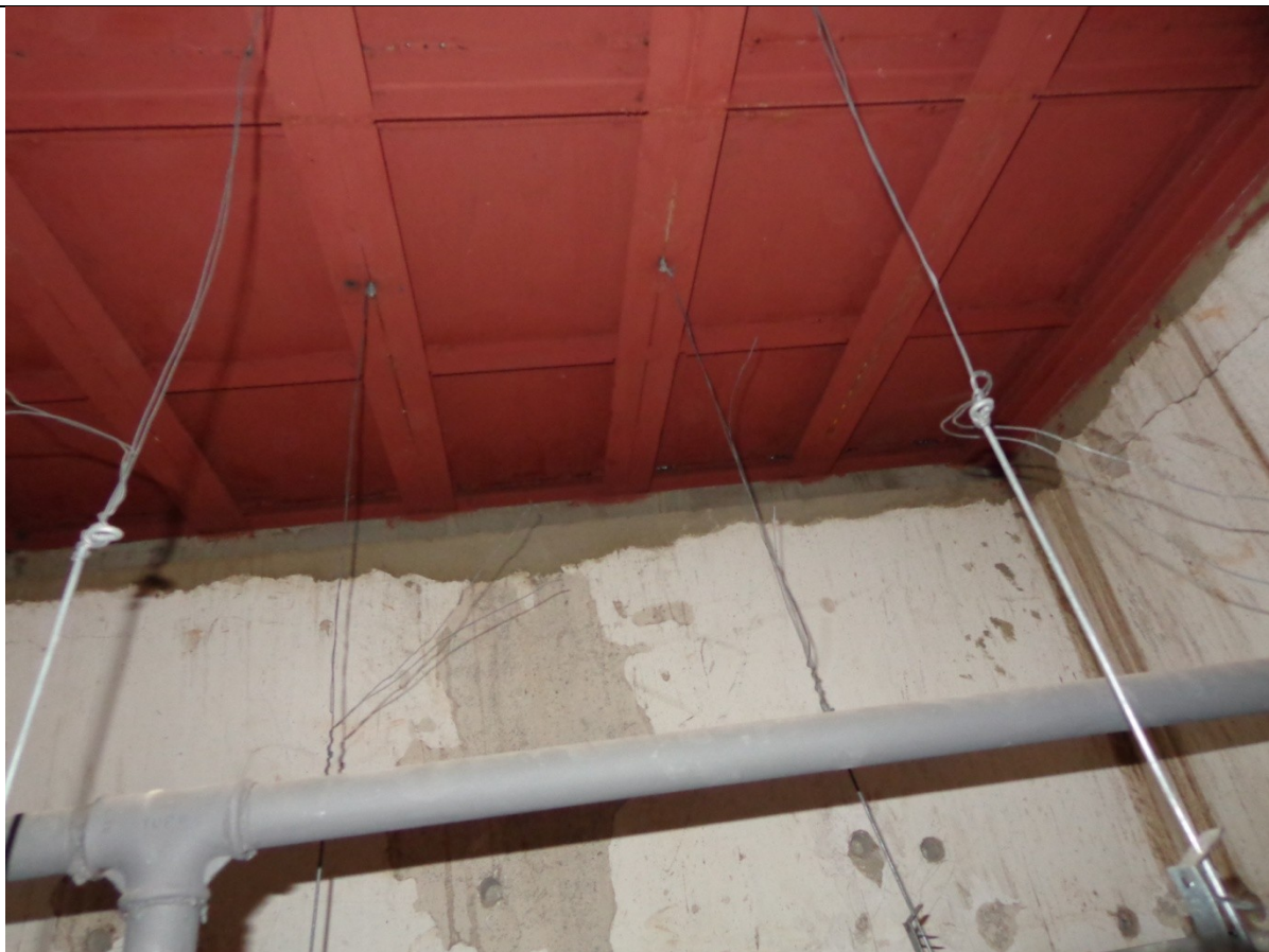
FOTO 13 – Alçapão do piso da casa de máquinas do edifício Anexo I. A CONTRATADA deverá realizar todos os serviços necessários – com fornecimento de materiais – para o acesso do 27º pavimento até a casa de máquinas, inclusive com a abertura desse alçapão.
