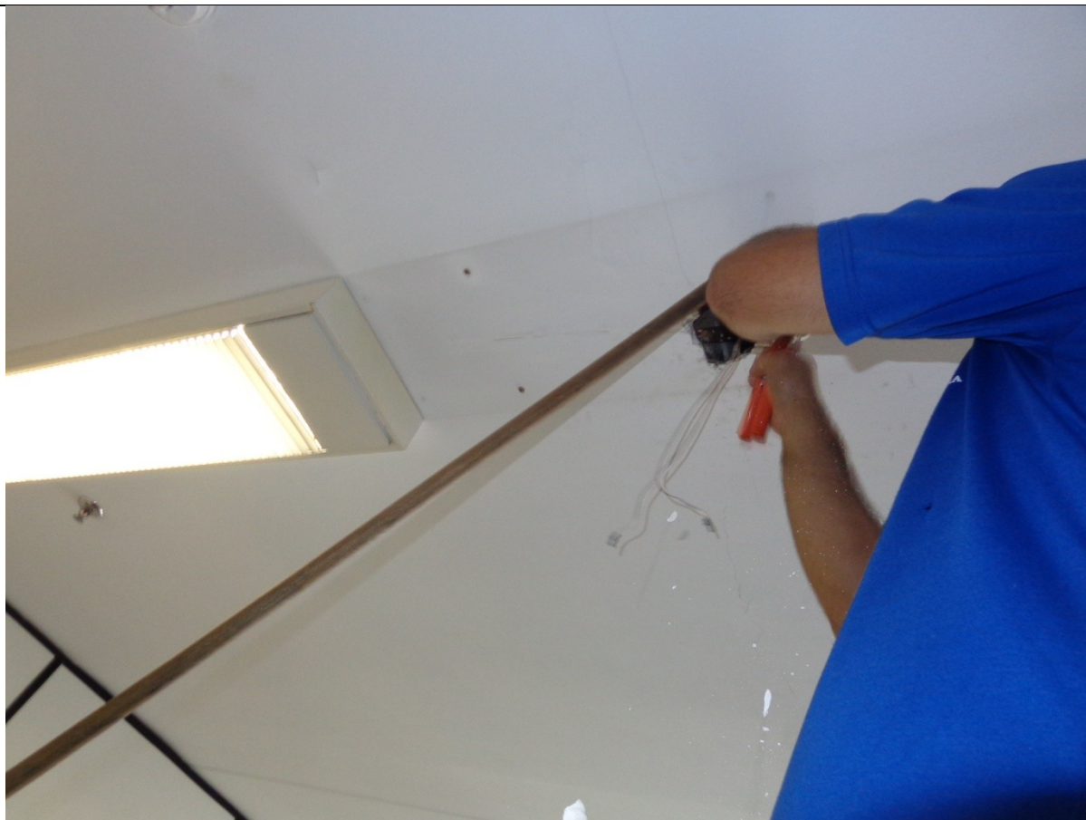
FOTO 12 – Teto do 27º pavimento do edifício Anexo I, localizado abaixo do alçapão da casa de máquinas dos elevadores desse edifício. A CONTRATADA deverá realizar todos os serviços necessários – com fornecimento de materiais – para o acesso desse pavimento até a casa de máquinas, inclusive com a remoção desse teto e abertura e instalação de alçapão.
