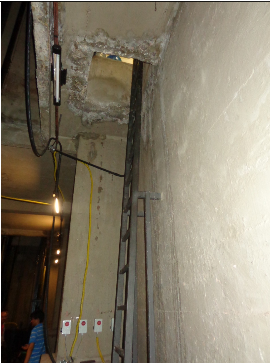
FOTO 10 – Detalhe da escada de acesso ao poço dos elevadores do edifício Anexo I. Esse modo de acesso deverá ser substituído conforme especificações do Anexo 04 do edital e pranchas gráficas desse Anexo, de forma a atender às normas vigentes aplicáveis.
