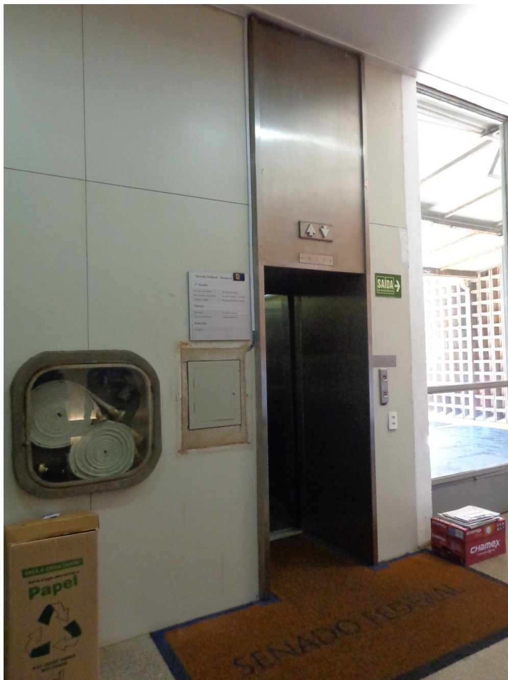
FOTO 38 – Marcos, soleiras, batentes, fachada, indicadores de posição e movimento, bota-eira e sinalização do elevador de serviço do Bloco A do edifício Anexo II no pavimento térreo. As peças de Laminado Decorativo de Alta Pressão na fachada para instalação de bota-eira na nova posição deverão ser substituídas conforme especificações do Anexo 04 do edital.
