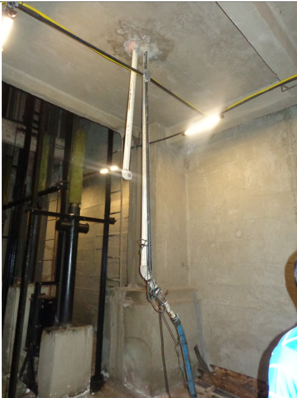
FOTO 2 – Instalação atual de bomba de sucção, de sistema elétrico e de iluminação no poço dos elevadores do edifício Anexo I. Essas instalações deverão ser substituídas quando da adequação desse poço conforme especificações do Anexo 04 do edital de forma a atender às normas vigentes aplicáveis.
