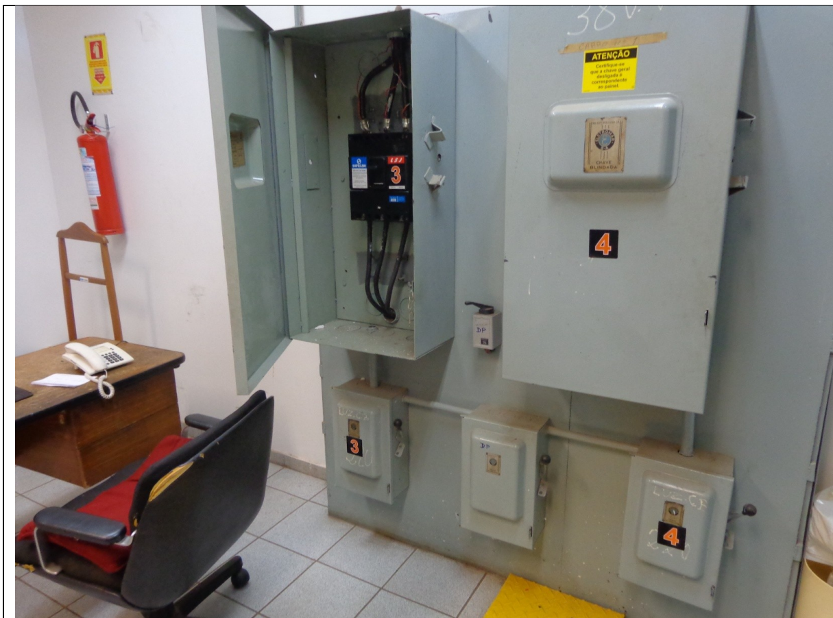
FOTO 16 – Quadros elétricos de elevadores em sala adjacente à casa de máquinas dos elevadores do edifício Anexo I. Esses elementos deverão ser substituídos conforme especificações do Anexo 04 do edital.
