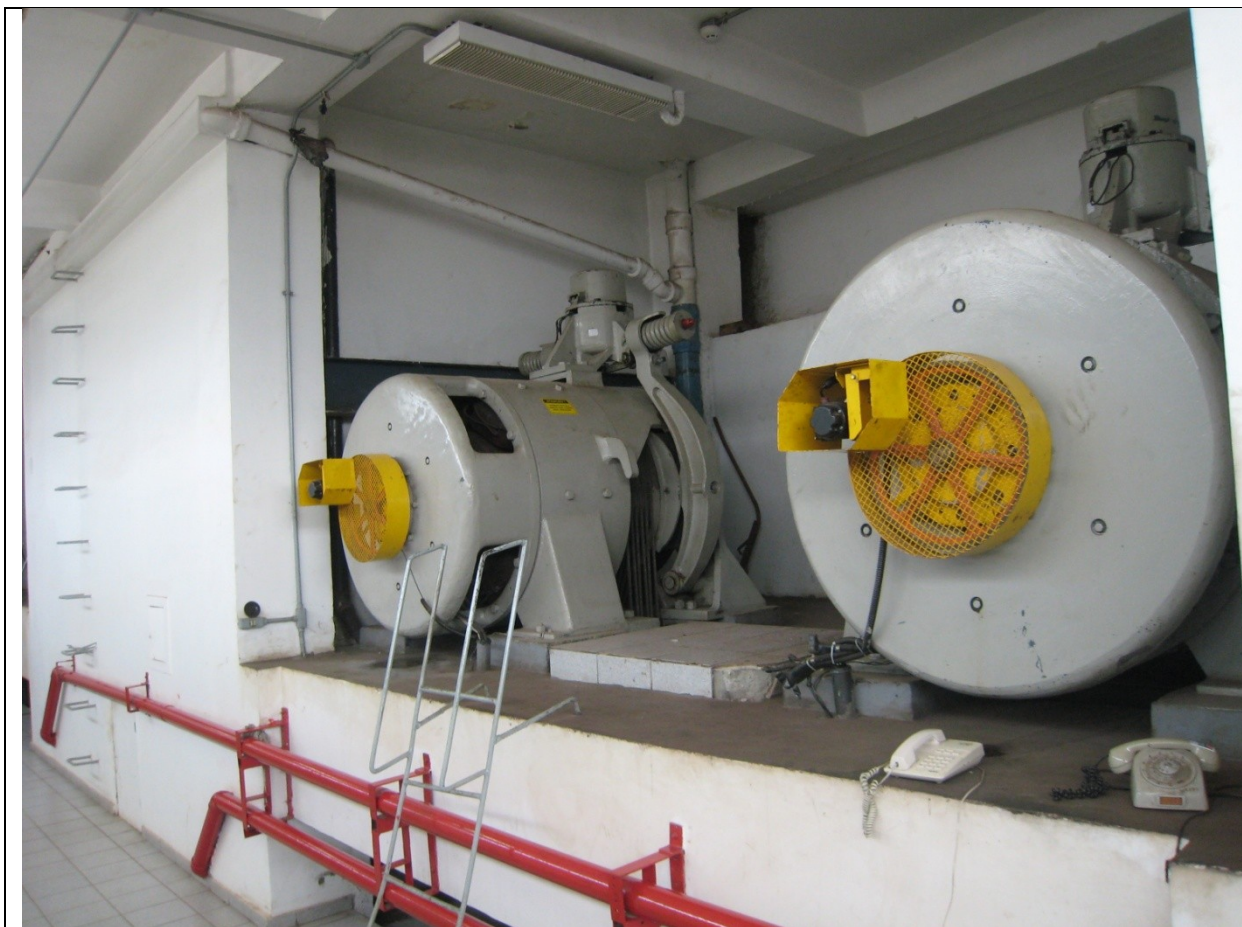
FOTO 11 – Máquinas de tração na casa de máquinas dos elevadores do edifício Anexo I. Esses elementos deverão ser substituídos conforme especificações do Anexo 04 do edital.
