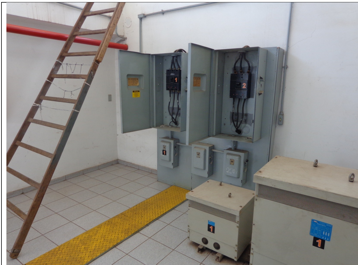
FOTO 15 – Quadros elétricos de elevadores na casa de máquinas dos elevadores do edifício Anexo I. Esses elementos deverão ser substituídos conforme especificações do Anexo 04 do edital.
