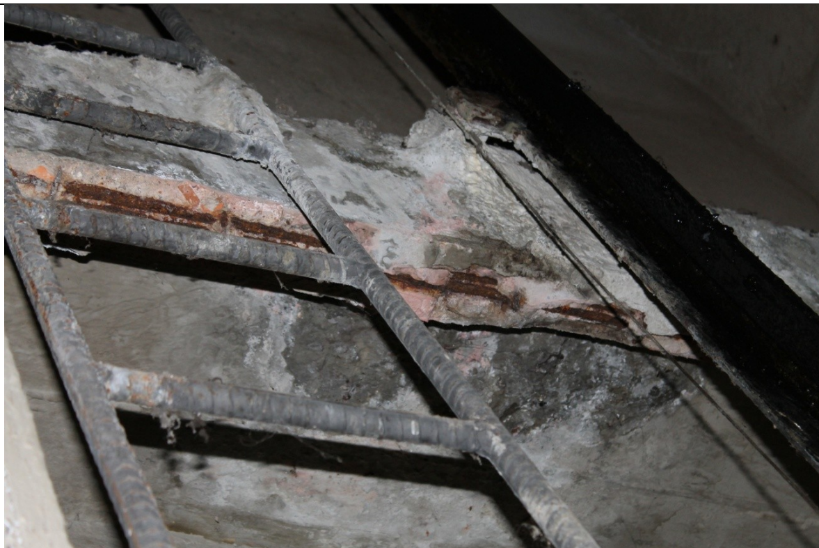
FOTO 5 – Parede no poço dos elevadores do edifício Anexo I.
