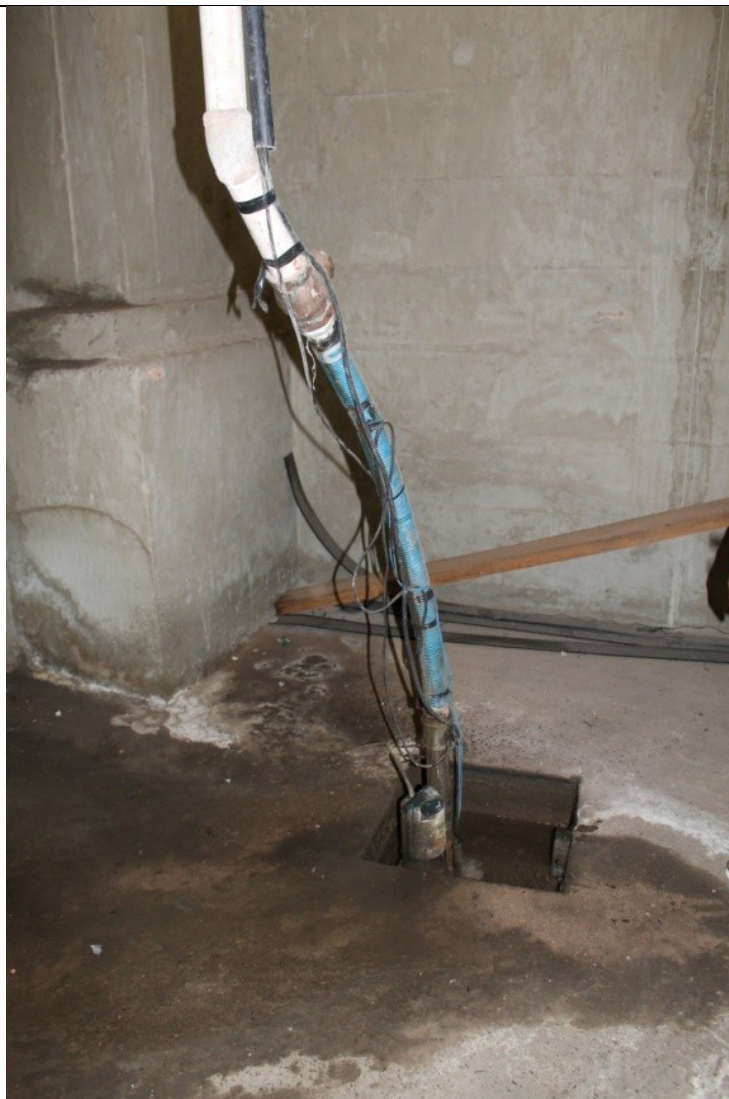
FOTO 1 – Instalação atual de bomba de sucção no poço dos elevadores do edifício Anexo I. Essa instalação deverá ser substituída quando da adequação desse poço conforme especificações do Anexo 04 do edital.
