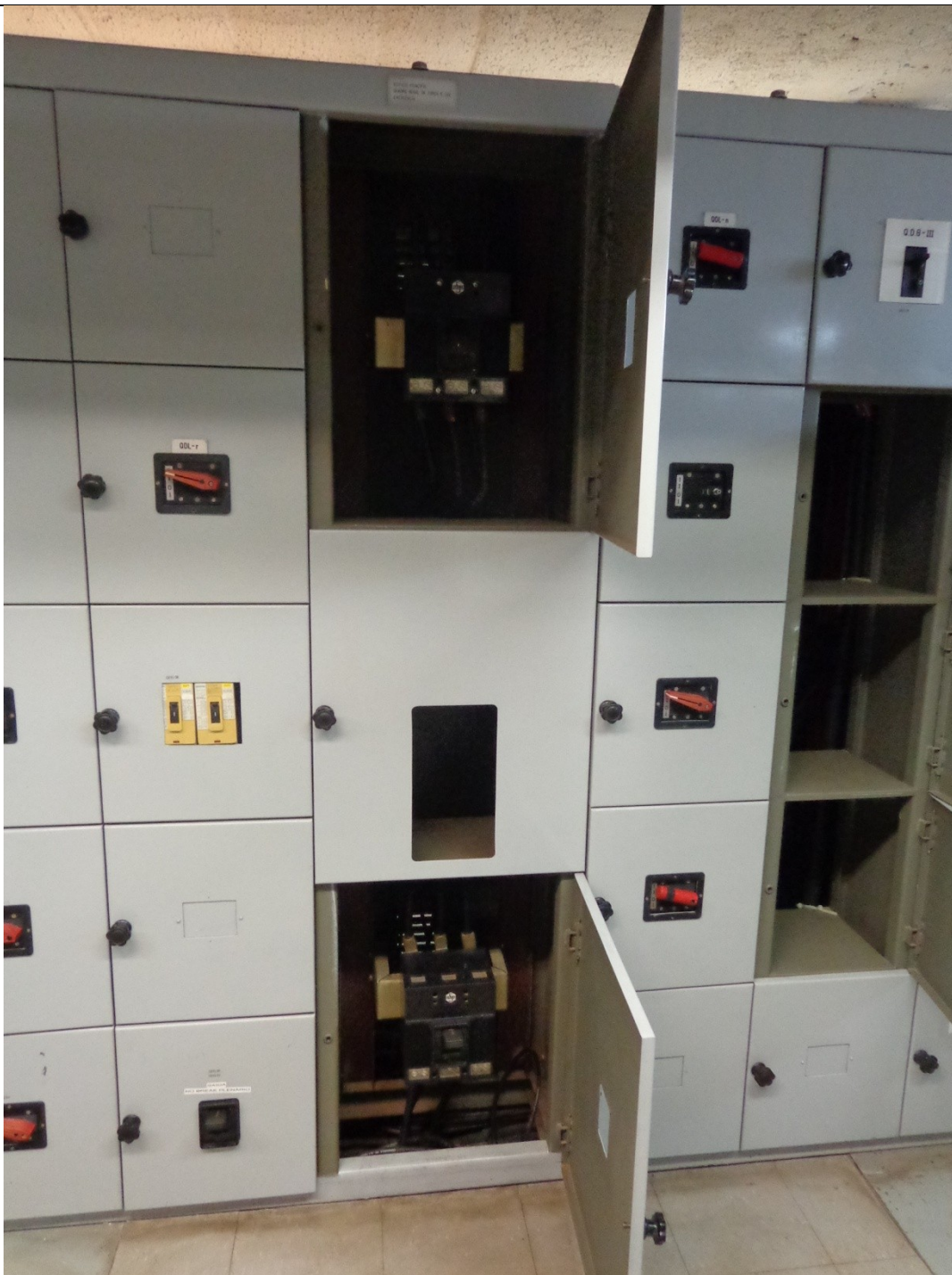
FOTO 17 – Painéis elétricos de elevadores na sala de quadros no subsolo no edifício Anexo I. Esses elementos deverão ser substituídos conforme especificações do Anexo 04 do edital.
