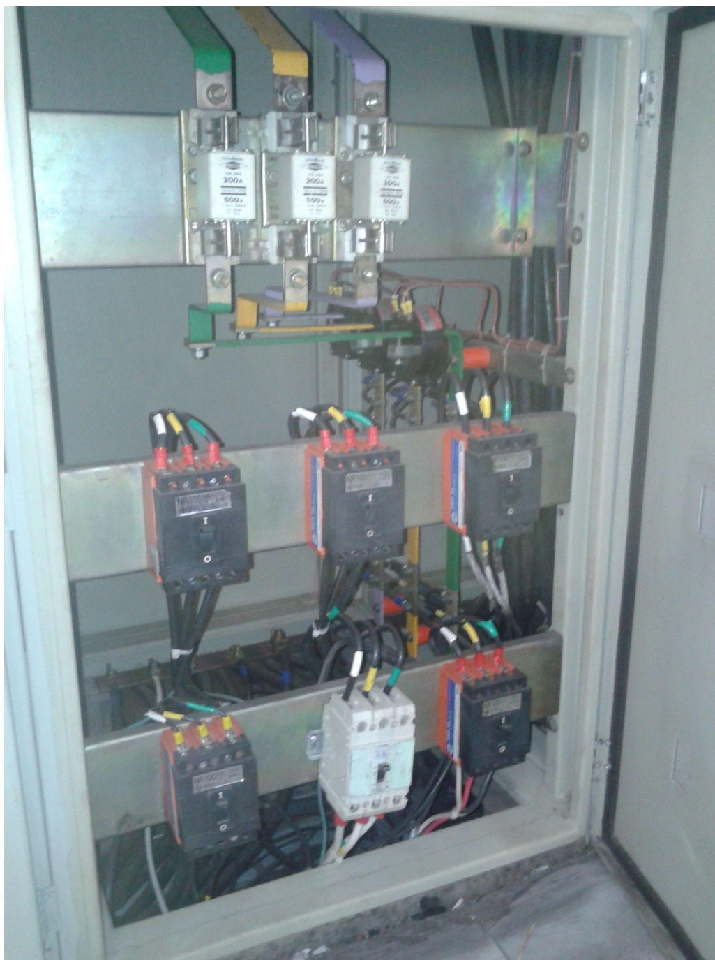
FOTO 29 – Um dos dois quadros de alimentação principal dos elevadores do Anexo II. Esses elementos deverão ser substituídos para um único Quadro de Alimentação Principal para os elevadores do Anexo II conforme especificações do Anexo 04 do edital.
