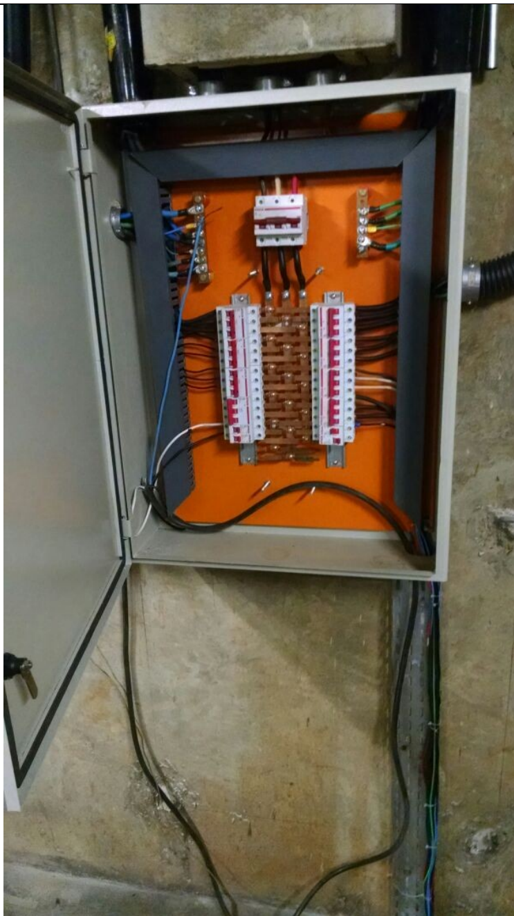
FOTO 25 – Quadro elétrico de elevadores na casa de máquinas dos elevadores do Edifício Principal. Esses elementos deverão ser substituídos conforme especificações do Anexo 04 do edital.
