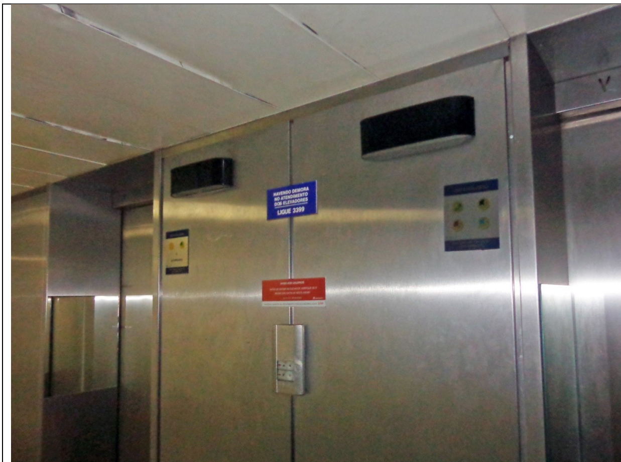
FOTO 18 – Indicadores de posição e direção, botoeira e sinalização dos elevadores do edifício Anexo I em pavimento tipo (do pavimento térreo até o 26º pavimento). Esses elementos deverão ser substituídos conforme especificações do Anexo 04 do edital.
