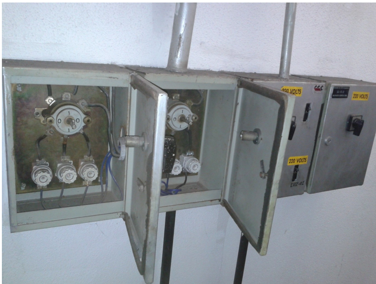
FOTO 42 – Quadros elétricos na casa de máquinas dos elevadores do Bloco B do edifício Anexo II. Esses elementos deverão ser substituídos conforme especificações do Anexo 04 do edital.
