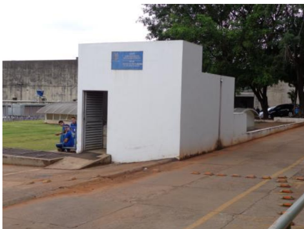
Casa de Máquinas 2
