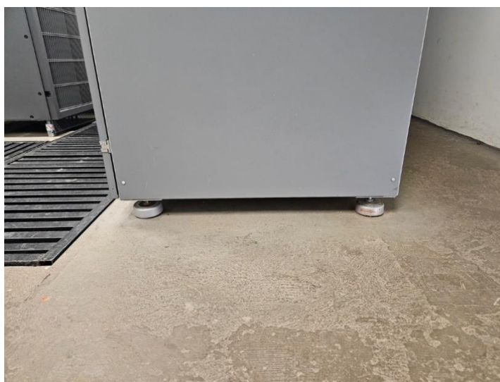
Figura 13 – Pés niveladores para o banco de baterias
