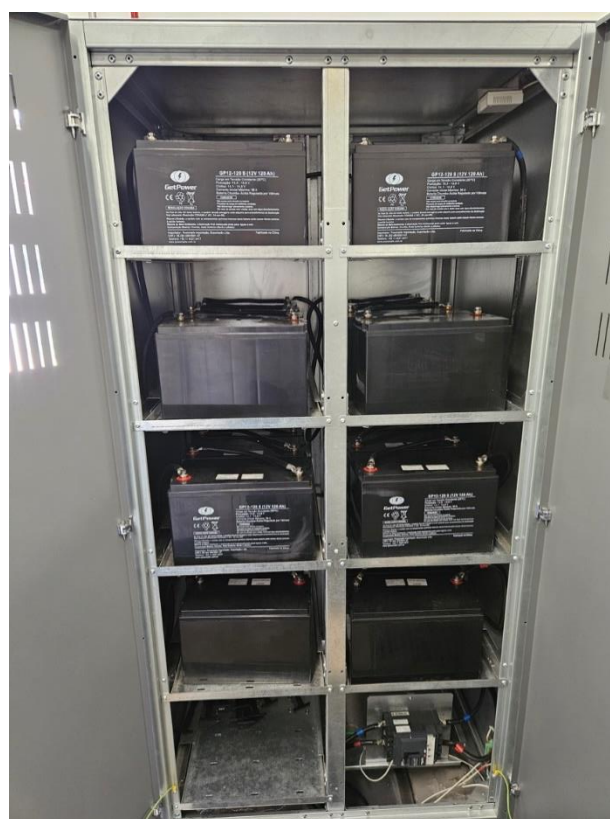
Figura 7 - Visão do banco de baterias aberto
