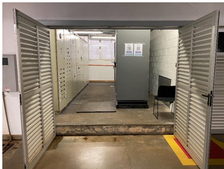
Figura 48 - Sala dos painéis e Nobreaks do Interlegis
