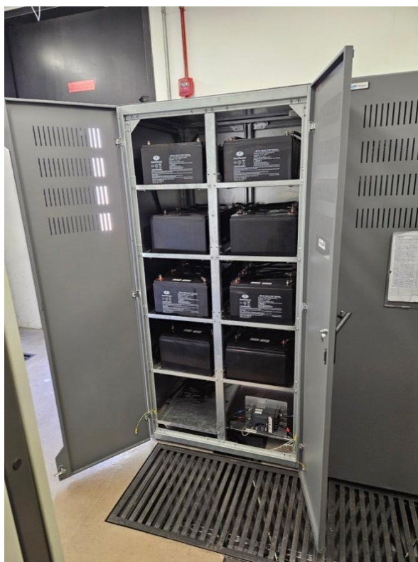
Figura 5 - Visão do banco de baterias aberto
