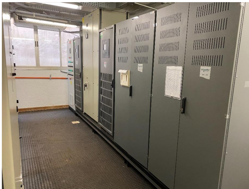
Figura 49- Espaço interno sala dos Nobreaks do Interlegis
