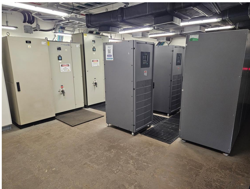
Figura 21 – Sala X do Prodase, com 4 nobreaks instalados
