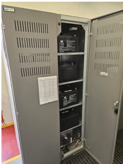
Figura 4 - Visão do banco de baterias
